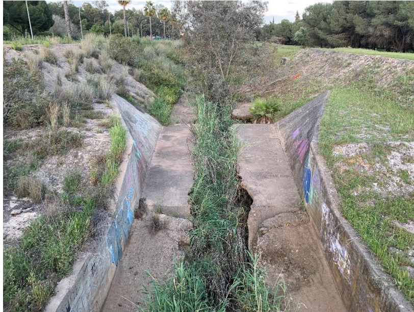
Figura 9. Deterioro en el Canal de Ranillas. Imagen propia
